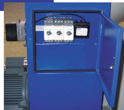
Электрощит. Электронный контроль.
